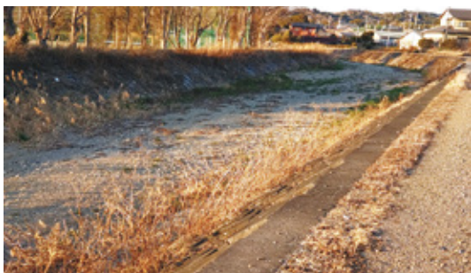
土砂が堆積した三沢川
